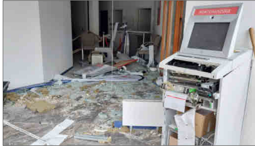
Der Sprengsatz zerstörte die Filiale der Sparkassen Versicherung in der Kemsstraße massiv.
